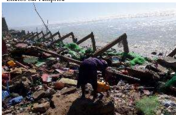
Digue emportée par la houle
