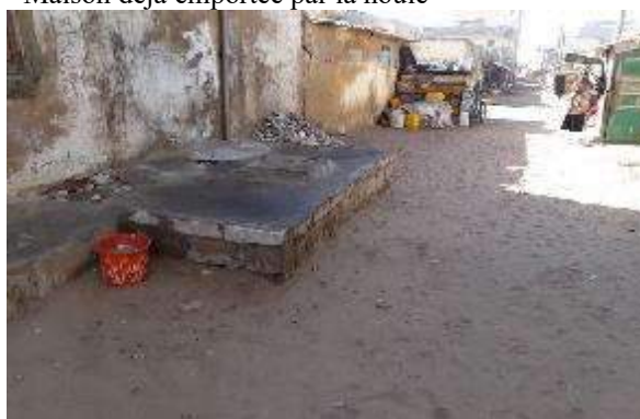
Fosse septique sur l'emprise
